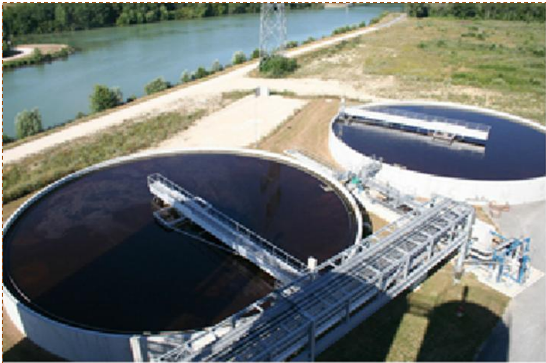
Bassin d'aérobic de la STEP
